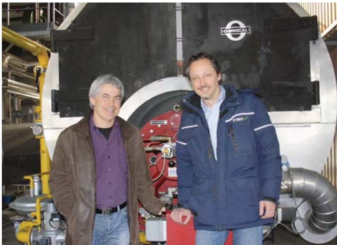
Roland Jacquéroiz et Daniel Claret, cofondateurs de PMAX, devant l'une des chaudières du chauffage à distance de Martigny dont ils ont optimisé l'usage pour un gain de 120 000 litres d'équivalent mazout par année. LE NOUVELLISTE
